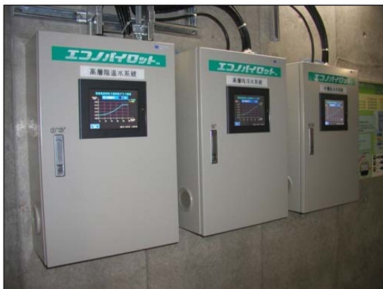
地下3階機械室に設置された「エコノパイロット」
